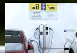
E-Ladestation und Parkplatz/ Parkhalle gehen in Betrieb
